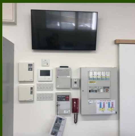
火災通報装置
